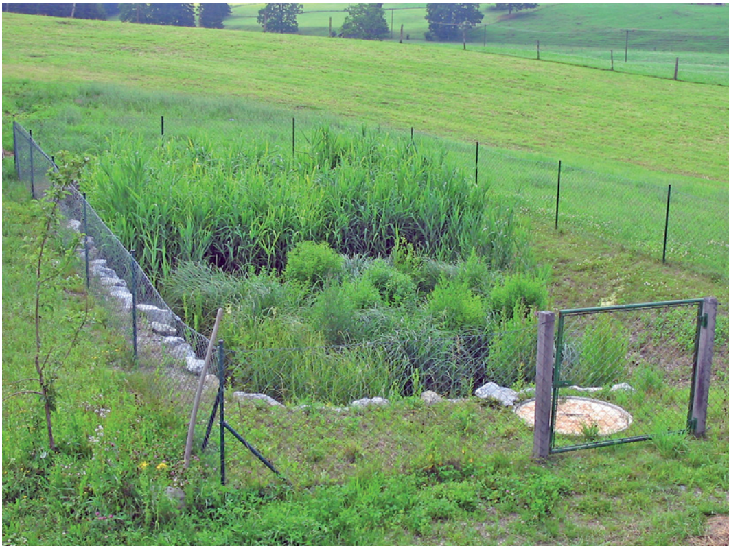
Abb. 6: Umzäunter bepflanzter Bodenfilter der Kleinkläranlage S
