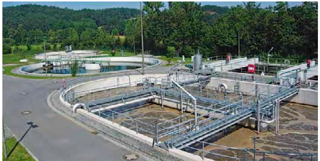
Belebungsanlage in Roding (25.000 EW Ausbaugröße)
