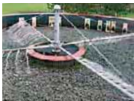
Tropfkörper der Kläranlage Horgau (4.500 EW Ausbaugröße)
