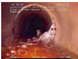
Fremdwasser im Kanal
