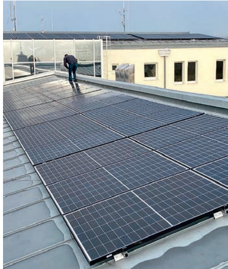
Die Solaranlage auf dem Dach des Landratsamtes. Bild: Immobilien- und Gebäudewirtschaft Landratsamt Miltenberg
