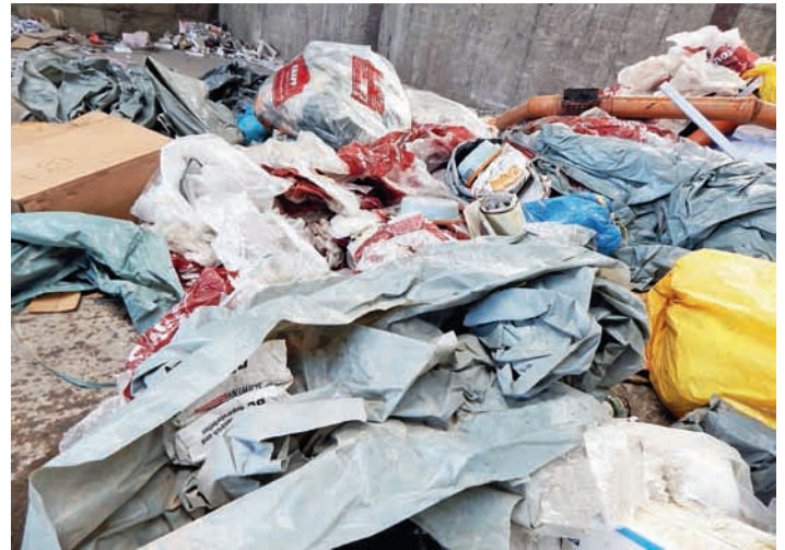
Gemischte Baustellenabfälle müssen immer getrennt angeliefert werden.
