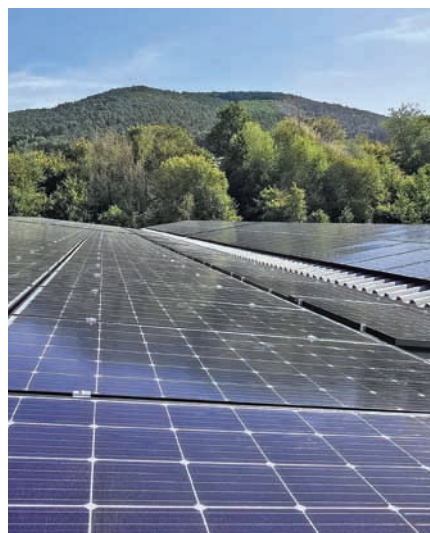
Die fertiggestellte PV-Anlage auf dem Wertstoffhof in Bürgstadt. Bild: Kai Strüber
