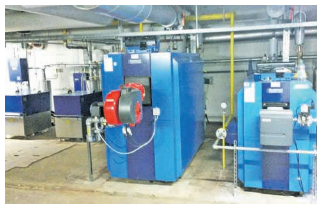
Links im Bildhintergrund die beiden Blockheizkraftwerke, im Vordergrund die beiden Gaskesselanlagen.
