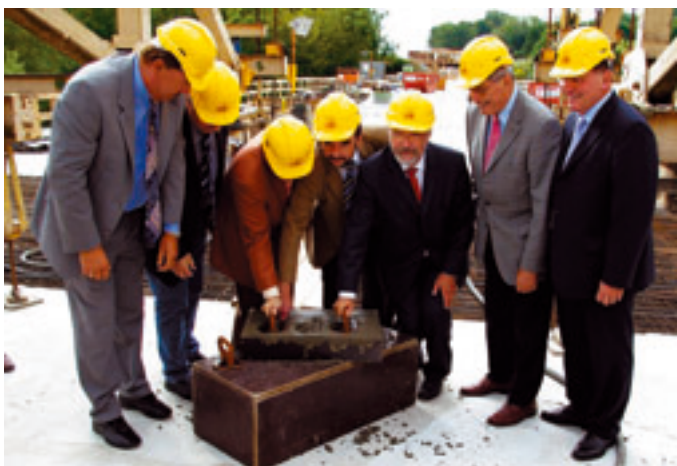
Mit vereinten Kräften wird vor dem Hintergrund des letzten Betonierabschnitts auf der neuen Mainbrücke die PPP-Gedenktafel gefertigt ... und der Schriftzug liebevoll modelliert.
