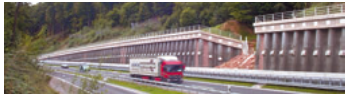
Herzstück der vierspurigen B 469 zwischen Obernburg und Würth ist die 400 Meter lange und bis zu 10 Meter hohe Bohrpfehlwand.
